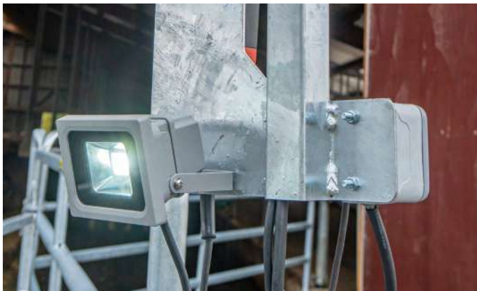
Tomas de corriente e iluminación LED
