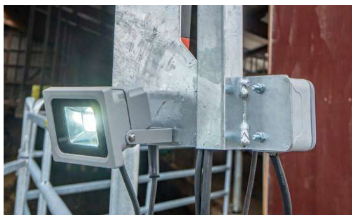
Prises électriques et projecteur LED
